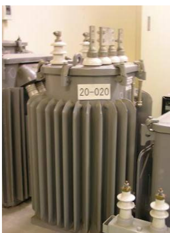
保管中のトランス
