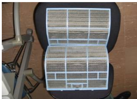
A棟 演習室 エアコンフィルター詰まり大
