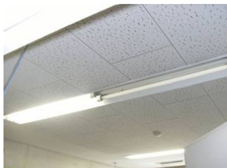
B棟 研究室 不要照明の間引き、消灯
