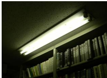
A棟 研究室 誰もいないのに照明点けっ放し
