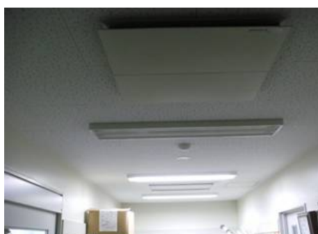
C棟 多目的室 不要部分の照明の消灯
