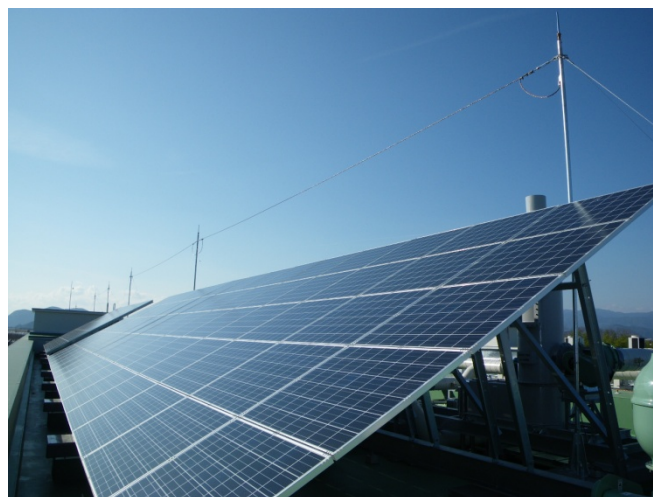
写真1 農学部3号館屋上に設置されている太陽光発電設備の外観
