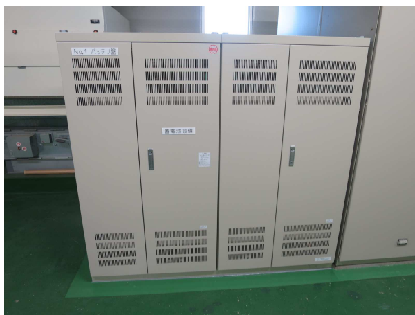
蓄電池盤外観
