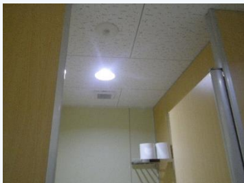
トイレブース内照明・換気扇
