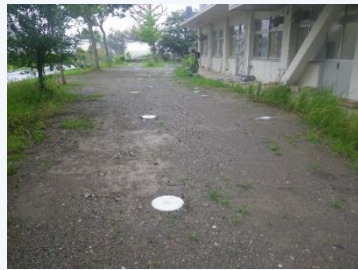
生活配水管（枅）
